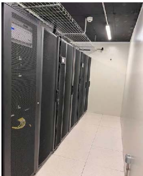
Figura 5: Vista interior do centro de dados EOLAB.
